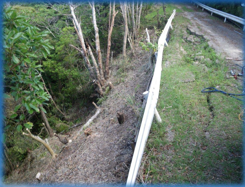
台風で崩壊した法面
